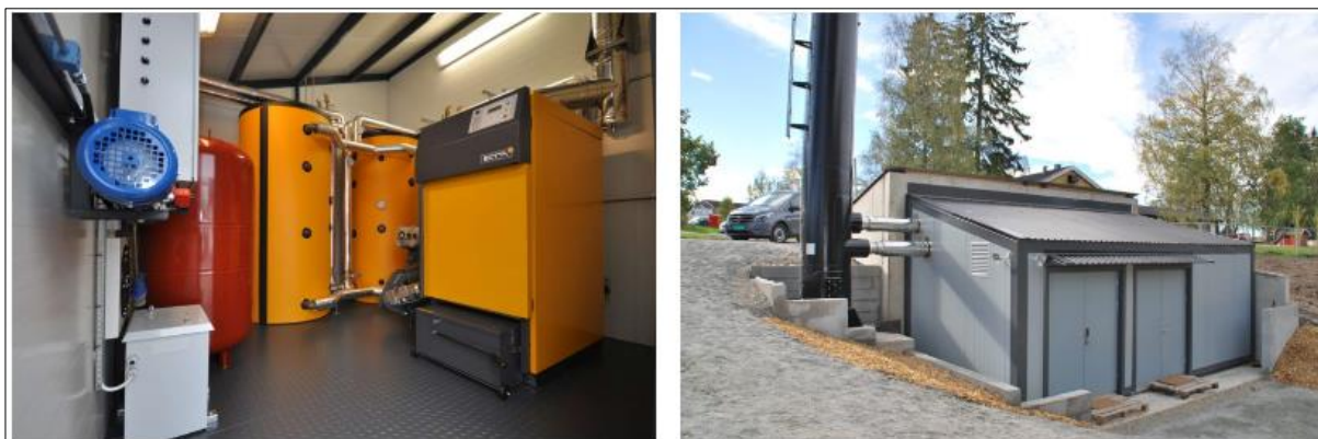
Figur 7-3. Eksempel på modulbasert varmeanlegg. (kilde: ETA Norge AS)
